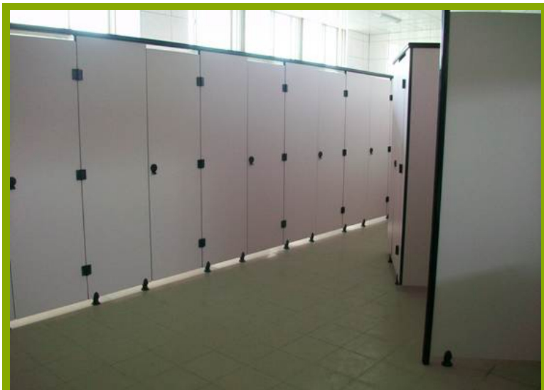
圖1：更衣淋浴間設施
