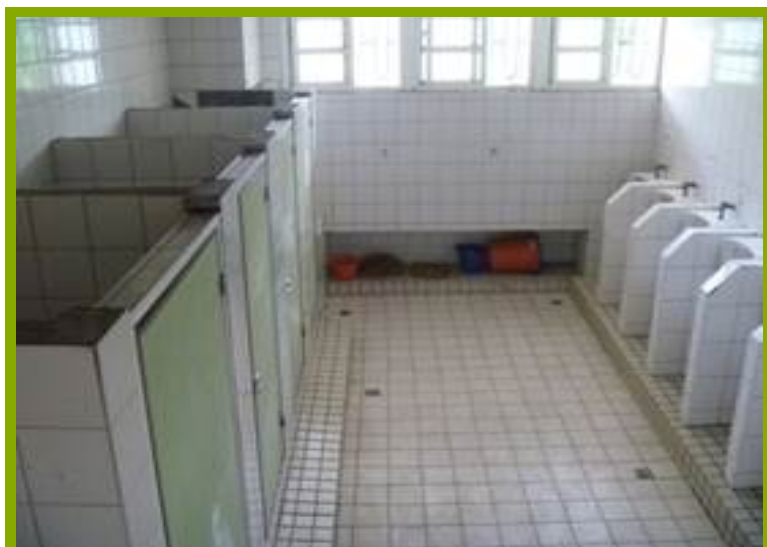
圖1：更衣淋浴間設施
