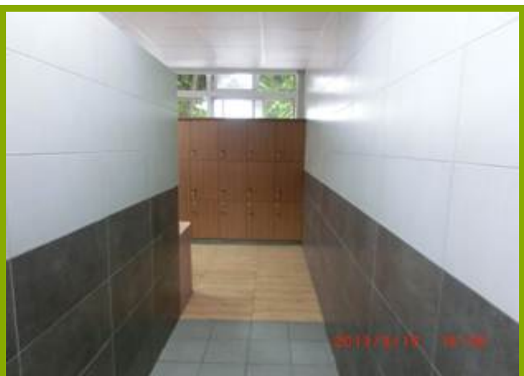
圖1：更衣淋浴間設施
